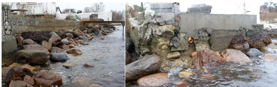
Figur 3-15 Betonmur delvist understøttet af sten ved matr. 6i, Dageløkke By, Humlebæk. Muren forsætter langs med kysten på hele matriklen.
