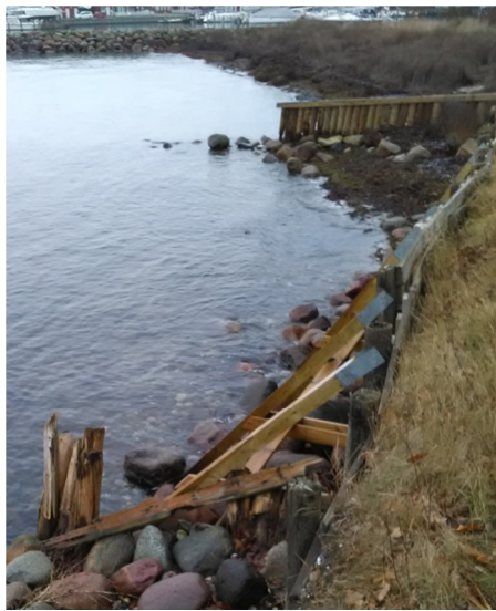
Figur 3-4 Pælevæg understøttet med reglar. I baggrunden ses en pælehøfde hvor stranden slutter.
