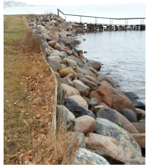
Figur 3-5 Pælevæg udsat for udskridning. Tillige ses sikring med små sten på op til ca. 40 cm.
