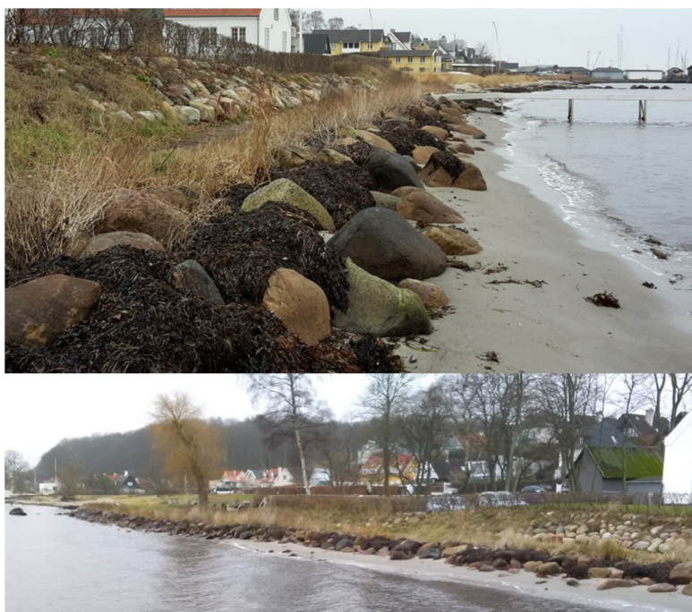
Figur 3-18 (Øverst) Todelt skråningsbeskyttelse startende ved matr. 13a, Sletten, Humlebæk. (Nederst) Overgangen mellem skråningsbeskyttelsen ved matr. 13d og 13a, Sletten, Humlebæk.
